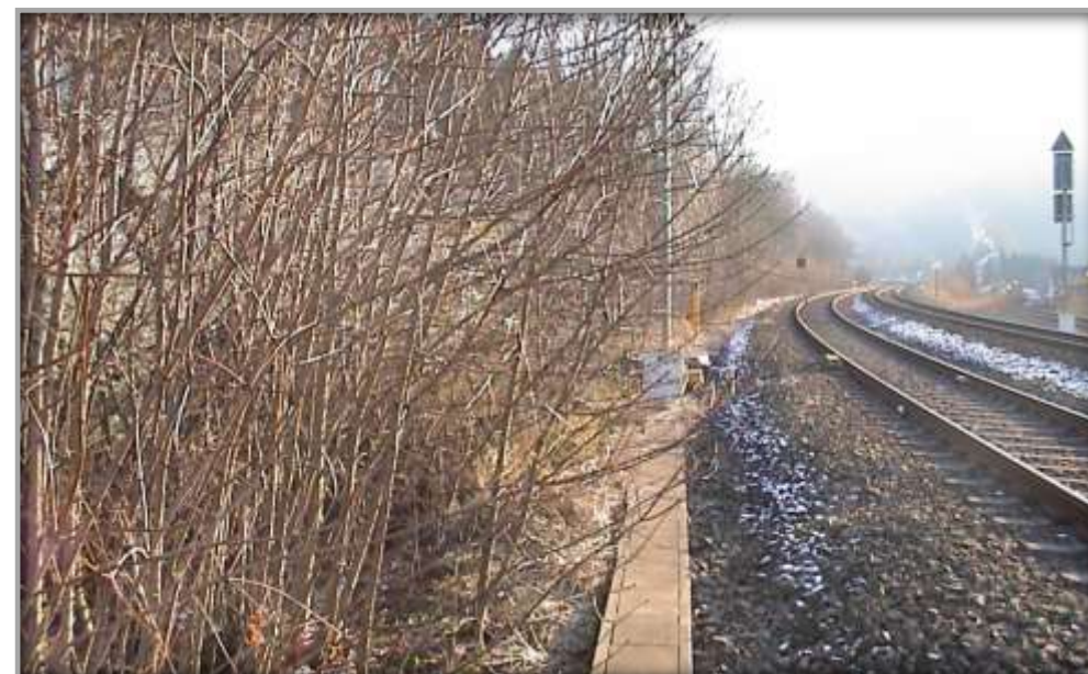
Unzugänglicher, durch Gemeindebewohner nicht nutzbarer Gleisrandbereich
